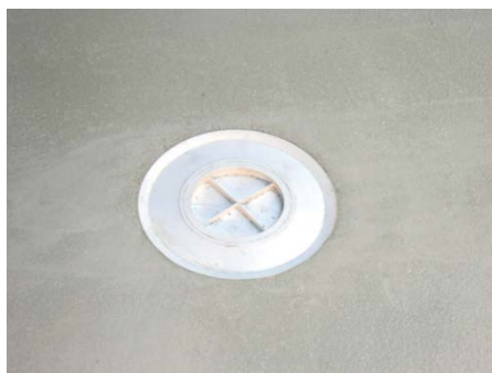
2. Betonovou mazaninu nechat vyzrát
